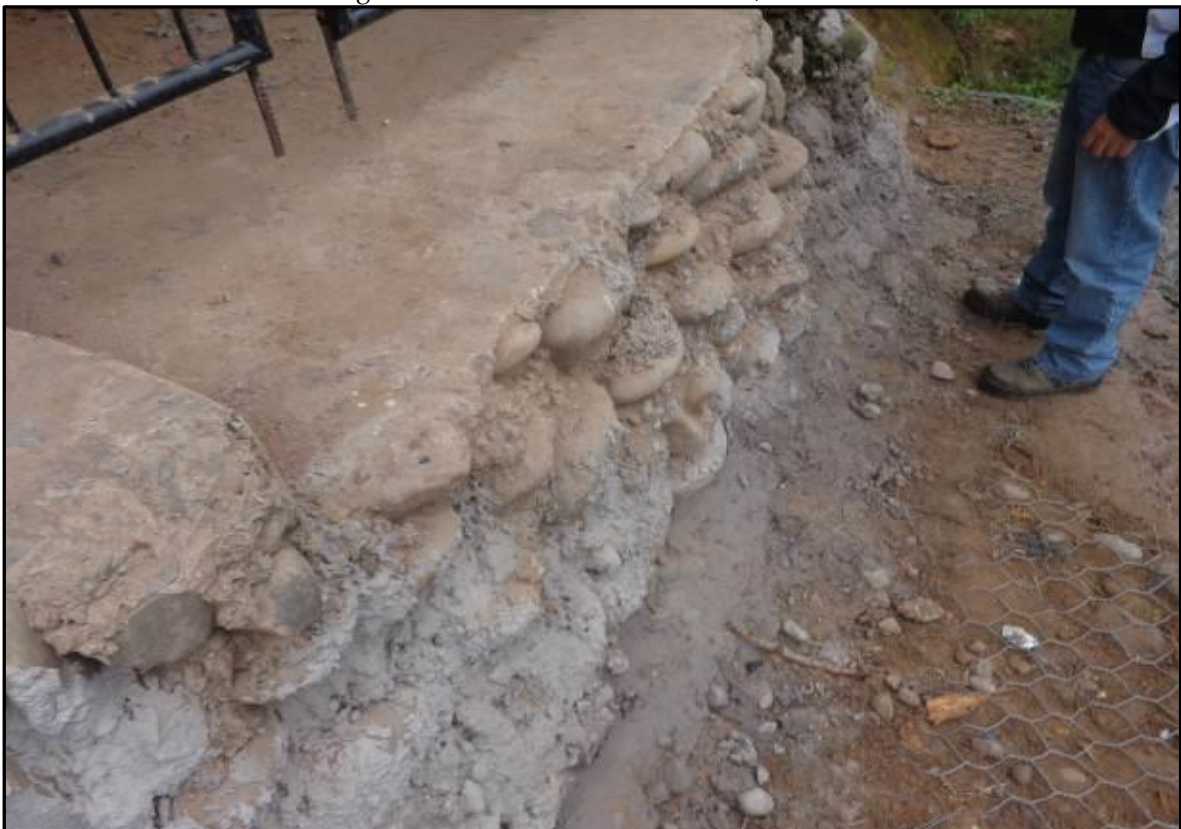
Fotografía N° 2: estado del piso de la casilla de aforo, año 2015
