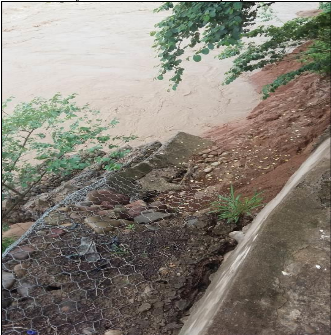
Fotografía N° 3: estado actual de gaviones junto a la casilla de aforo estación.
