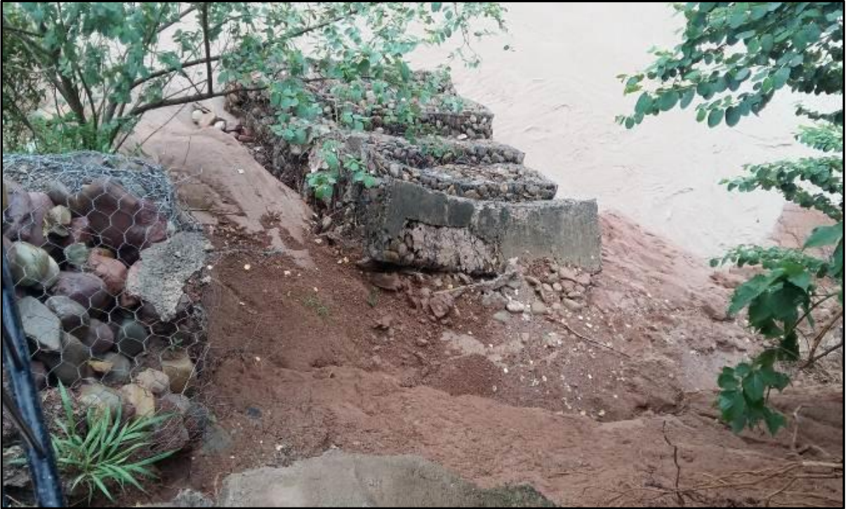
Fotografía N° 2: estado actual de la barranca y los gaviones.
