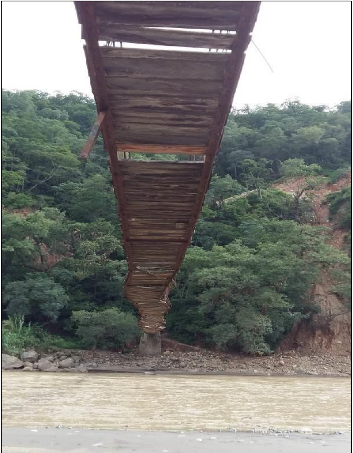
Fotografías N° 4: estado de la pasarela estación San Josecito, año 2018
