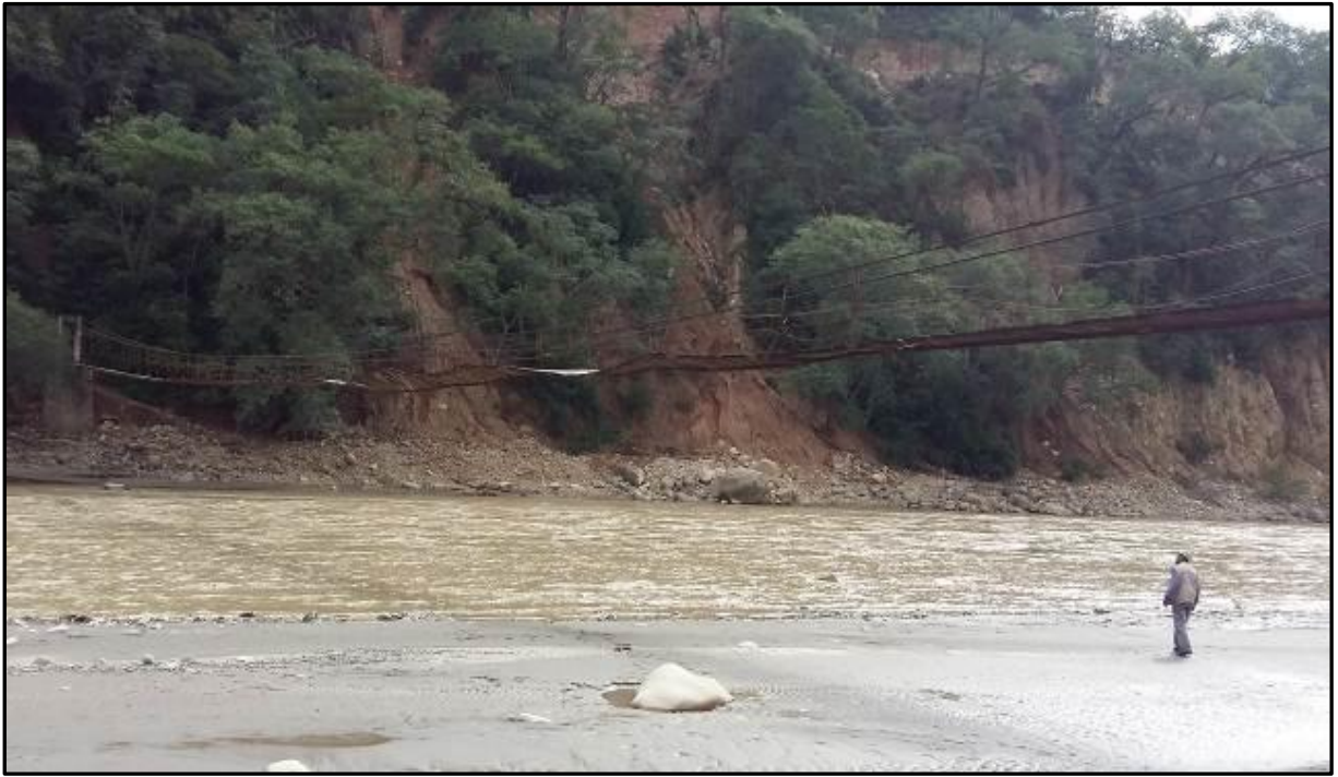
Fotografía N° 2: estado de la pasarela estación San Josecito, año 2014
