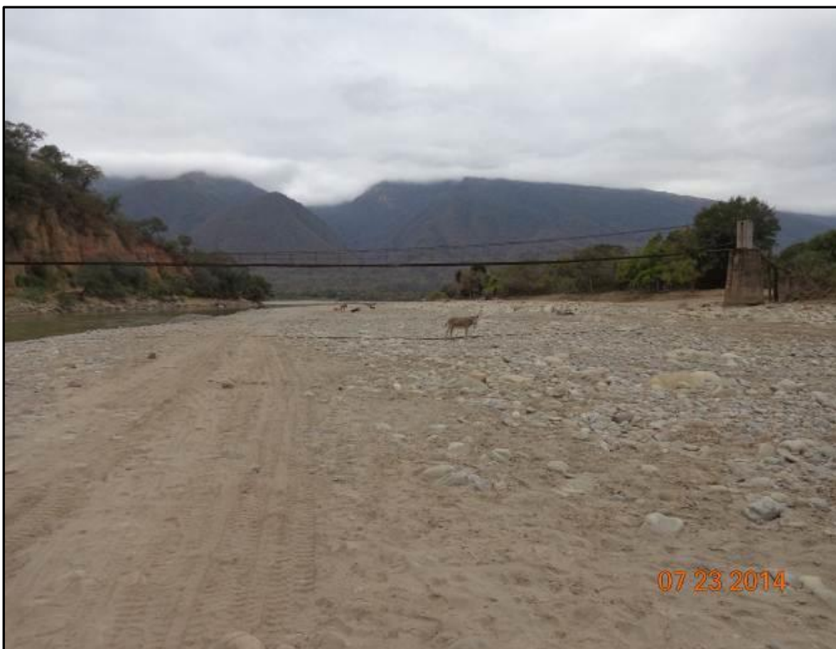
Fotografía N° 1: estado de la pasarela estación San Josecito, año 2014
