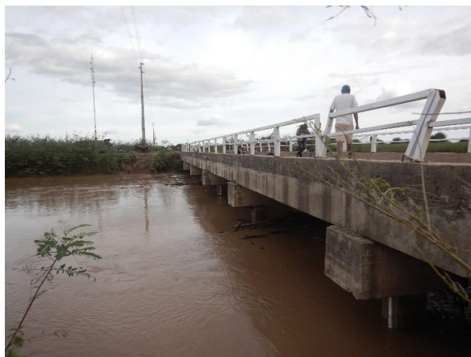
Fotografía 66. Canal Paraguayo en General Díaz – Vista del nivel del agua en el puente
