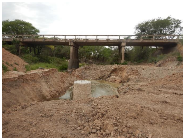
Fotografía 21. Río Negro en ruta PY09 – Vista del puente carretero desde aguas arriba
