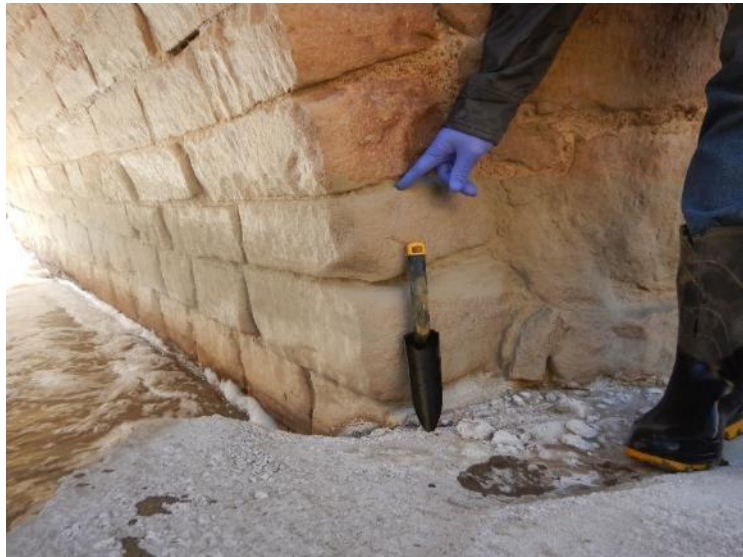
Fotografía 45. Altura de la marca en el puente antiguo de la carretera a Oruro (45 cm aprox.)
